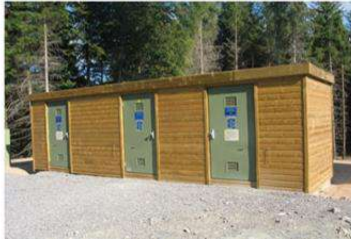
Figure 20 : Exemple d'un poste de livraison (Source : EDF Renouvelables)
