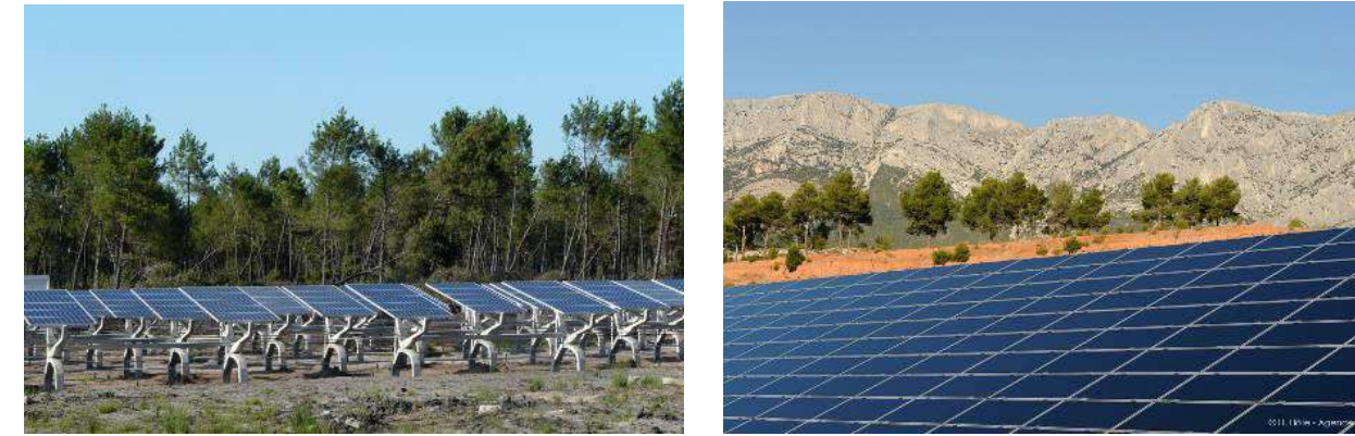
Photographie 1 : Structures solaires (à gauche: les trackers de la centrale de Gabardan (40) qui suivent le soleil ; à droite : structures fixes à Puylobier (13)) - Source : EDF RENOUVELABLES
